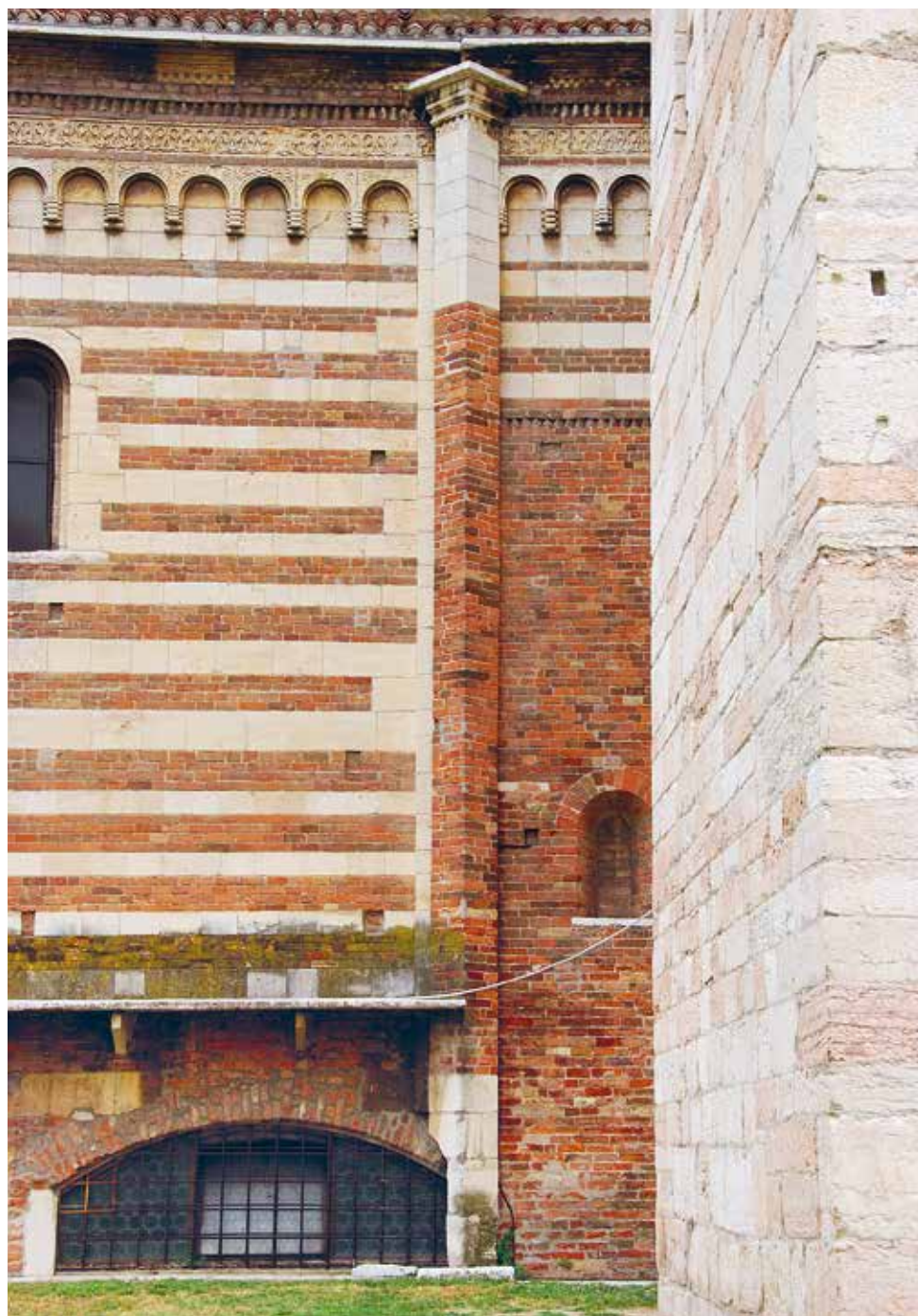
Fig. 6. Perimetrale sud, esterno, verso testata absidale, con il punto di contatto fra le due fasi romaniche in corrispondenza del contrafforte a sperone e in primo piano il campanile di Alberico.
