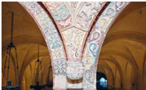
Fig. 37. Settore centrale dei varchi di accesso, pennacchio al di sopra della colonna binata fra la terza e la quarta arcata.
