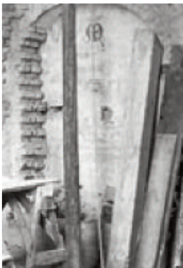
La parete destra dell'abside verso il coro: particolare della porta tamponata e riportante un monogramma (ASDMn, Fondo Menna, Cassa 3, b. 4).
